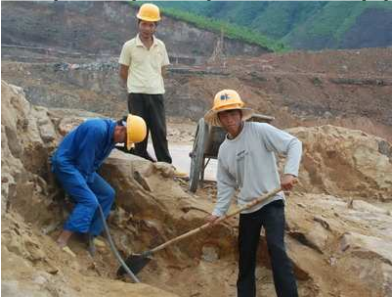
Phần đông công nhân Trung Quốc đến với dự án Nhà máy nhiệt điện Nông Sơn (Quảng Nam) đều là lao động phổ thông. Trong ảnh: một nhóm công nhân đang làm nhiệm vụ khoan đá, xúc đất (ảnh chụp chiều 15-4) - Ảnh: Đăng Nam (Tuổi Trẻ)
